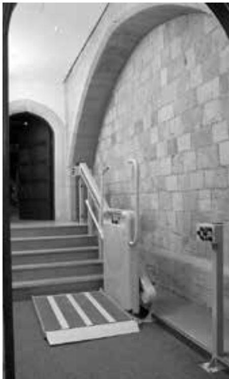
Inneninstallation auf Pfosten. Palace of Westminster, Großbritannien.
