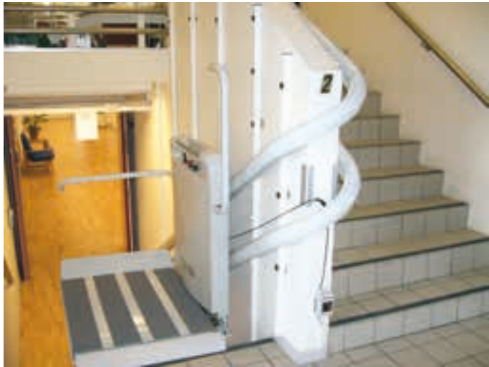
Inneninstallation mit 180 grad Biegung auf dem Treppenabsatz. Öffentliches Gebäude, Dänemark.
